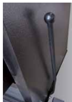
Привод механизма очистки топочной решетки
